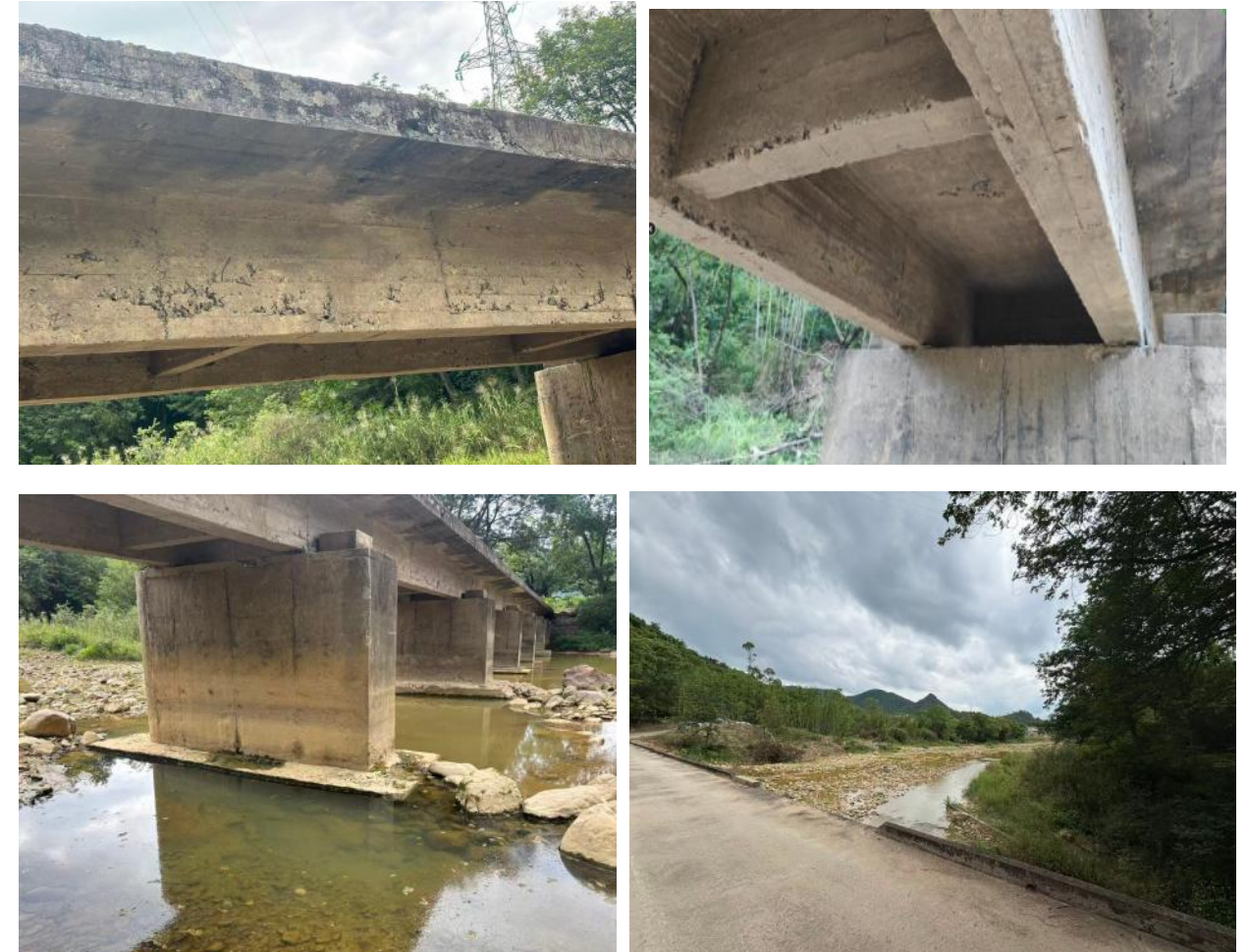
老桥部分病害图
