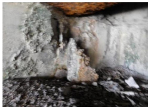
悬臂梁根部混凝土剥离
