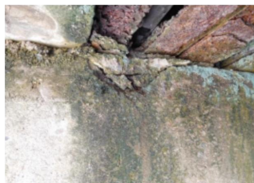
悬臂梁边角混凝土剥离
