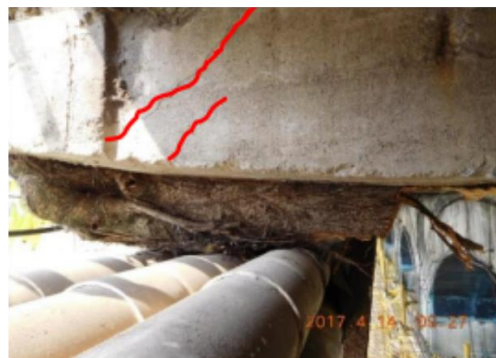
悬臂梁结构裂缝（斜向）
