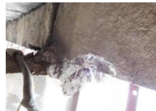
纵梁底面混凝土剥离
