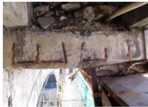
悬臂梁侧面露筋锈蚀
