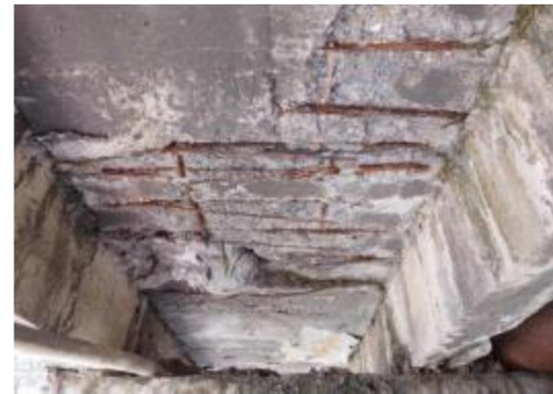
人行道板底面混凝土剥离
