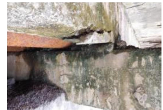
纵梁底面混凝土剥离
