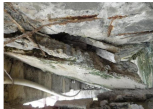
人行道板底面混凝土剥离
