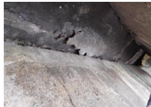
人行道板底面混凝土剥离
