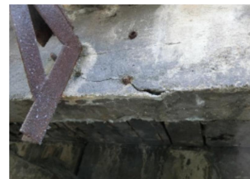
纵梁侧面结构裂缝（斜向）
