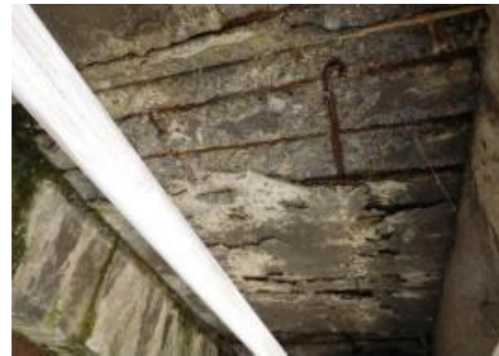
人行道板底面混凝土剥离
