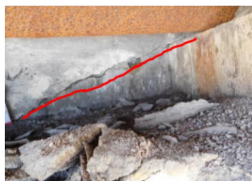
悬臂梁结构裂缝（斜向）
