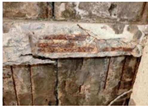
悬臂梁底面露筋锈蚀
