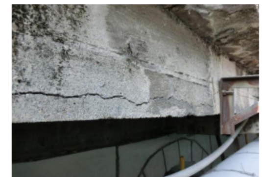
纵梁侧面结构裂缝（纵向）
