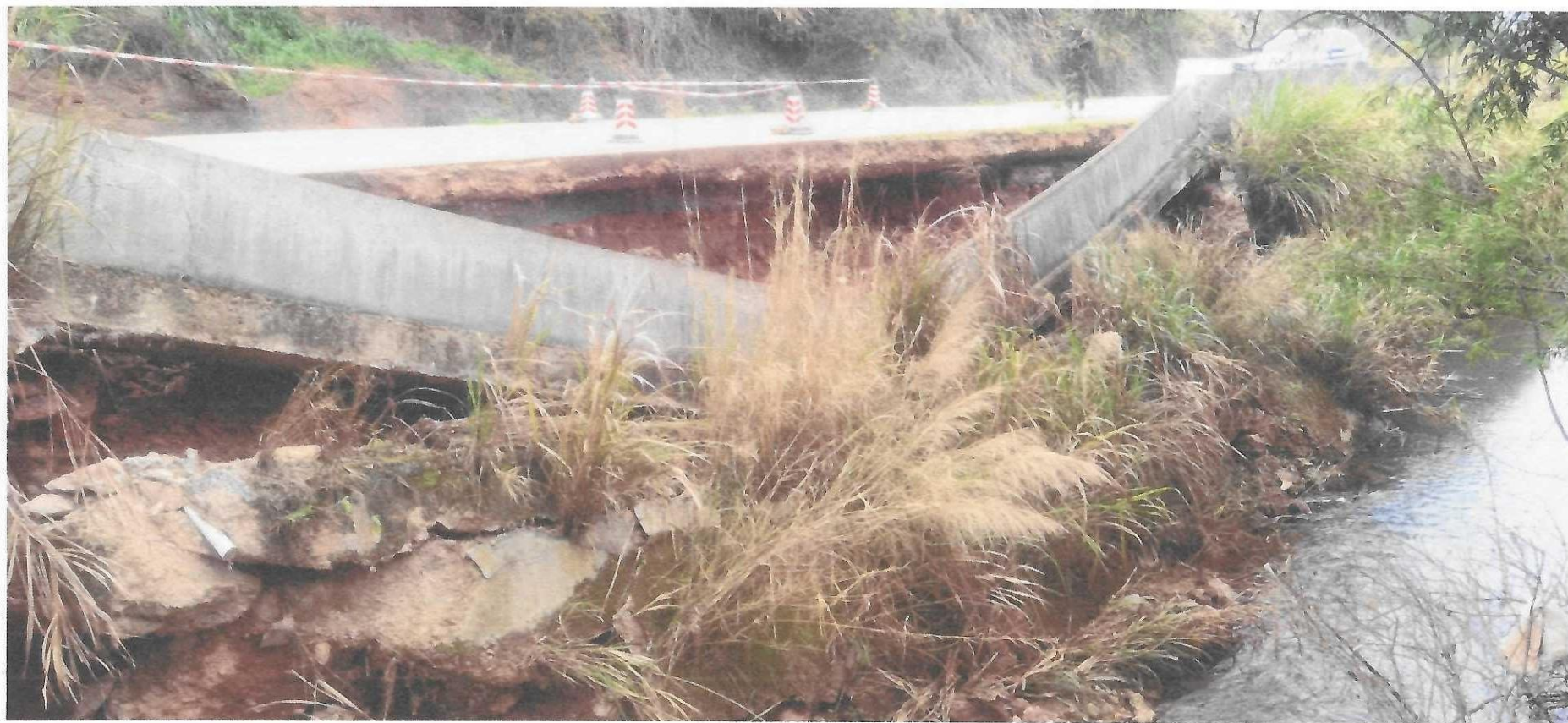
韶关市始兴县 X793 线 K10+260 处现场损毁照片
