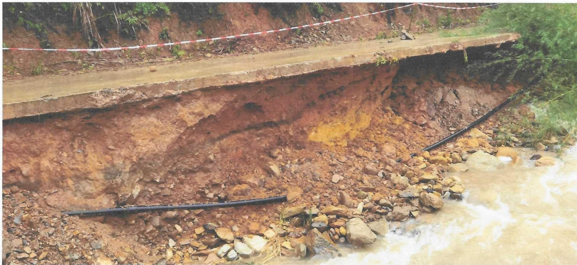
韶关市始兴县 Y463 线 K0+900 处现场损毁照片
