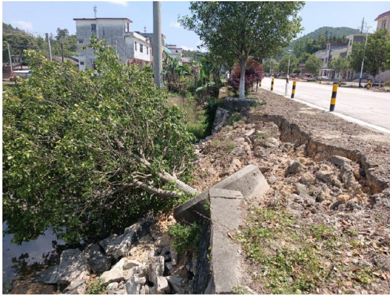
国道 G220 线 K2380+460~K2380+495 处 右侧挡土墙坍塌
