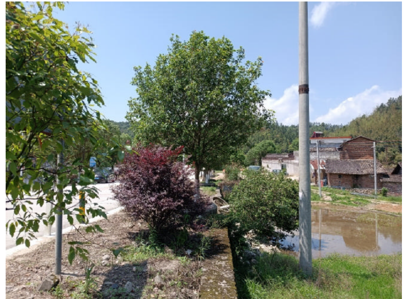
国道 G220 线 K2380+460~K2380+495 处 右侧挡土墙坍塌
